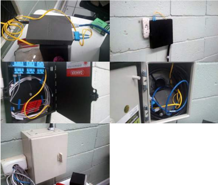
FIGURA 1. INSTALACIONES DE CABLEADO Y EQUIPO EN EL COLEGIO DE BACHILLERES DE SINALOA, 26, EN CULIACÁN, SINALOA
