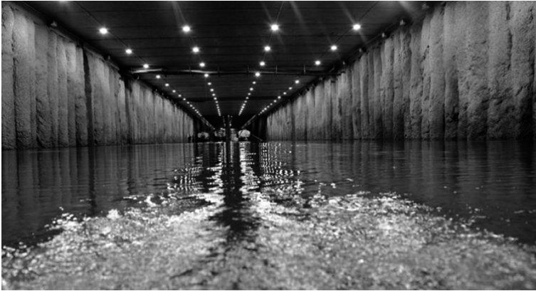
FIGURA 14. PASO A DESNIVEL BOULEVARD PEDRO INFANTE, AFECTADO POR LLUVIAS Y SIN SISTEMA DE BOMBEO.
