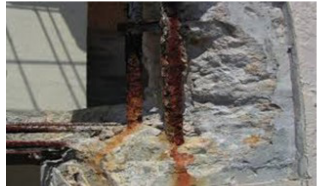
Figura 1 Efectos de la corrosión en el CR
