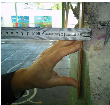
Figura 3. Ensayo de carbonatación
