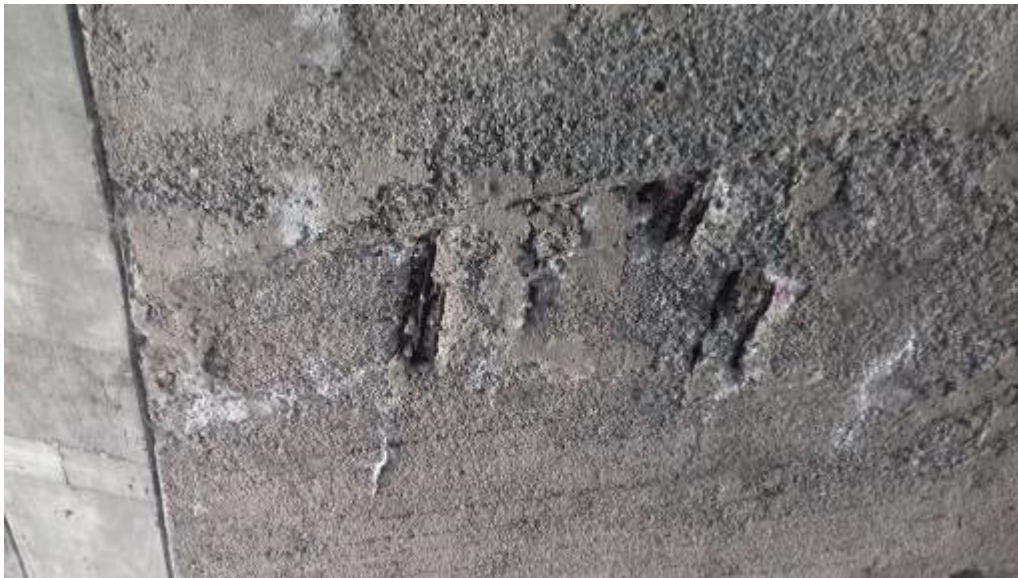
Figura 13. Degradación del concreto por corrosión de armaduras
