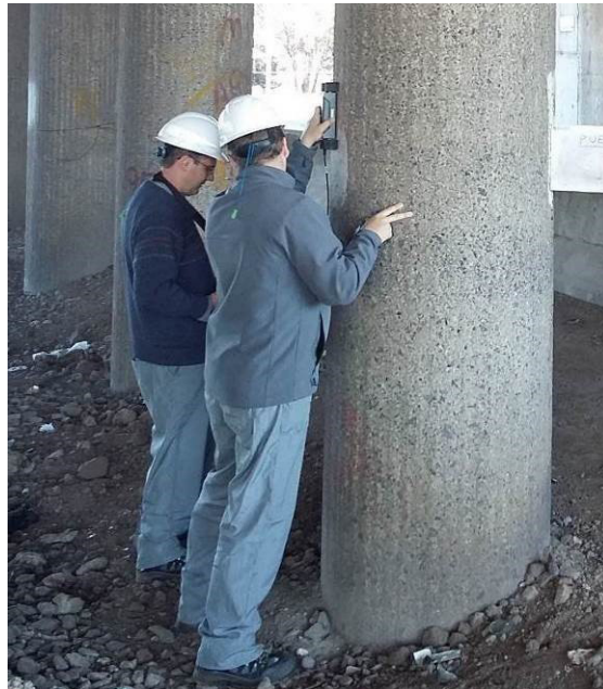
Figura 11. Detección de armaduras en columna
